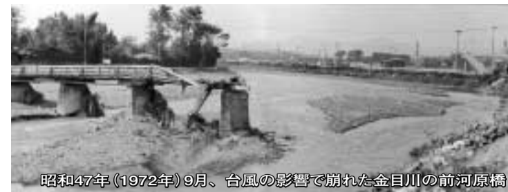
昭和47年(1972年)9月、台風の影響で崩れた金目川の前河原橋
