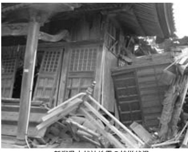
新潟県中越沖地震の被災状況
