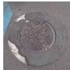
マンホールがガタついている。
