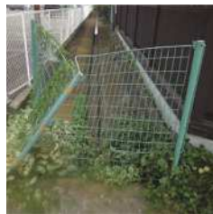
転落防止柵が壊れている。
