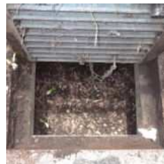
集水樹内に土砂が堆積している。
