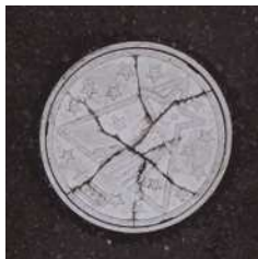
公共樹のフタが割れている。
