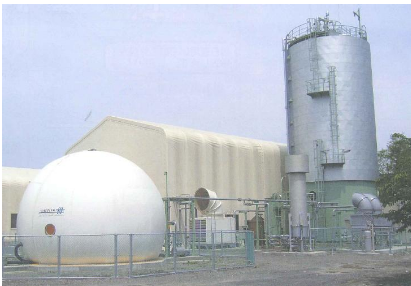
乾式メタン発酵設備（縦型；長野県安曇野市実証設備）
