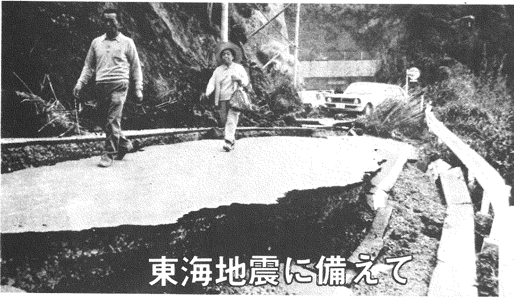
伊豆大島近海地震による大きな地割れ
