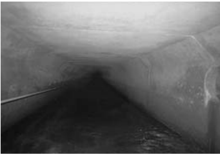
老朽化が進む管渠
