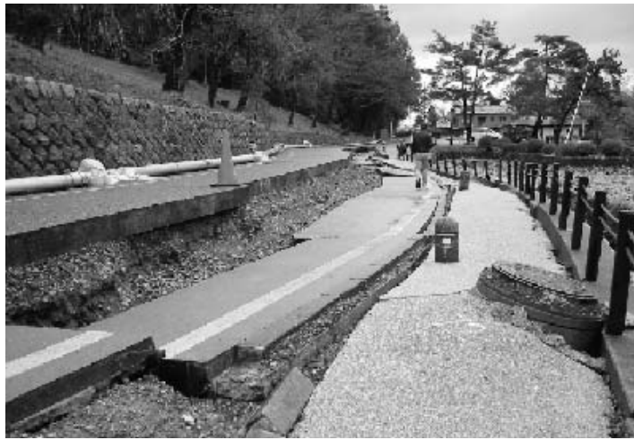
寸断された道路(新潟県中越地震)
