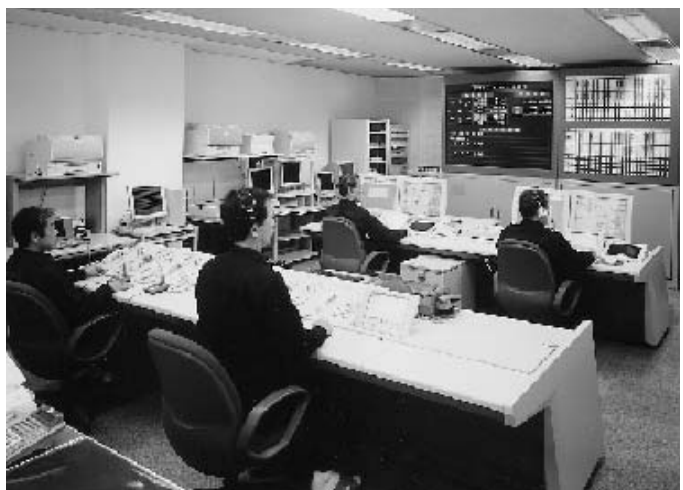
消防署 通信司令室
