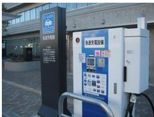
市庁舎本館に設置された電気自動車用急速充電器
