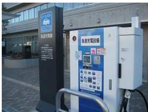
市庁舎本館に設置された電気自動車用急速充電器
