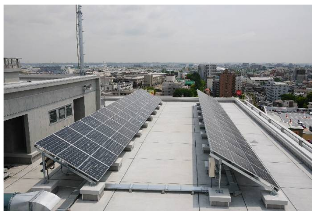
市庁舎本館の太陽光パネル
