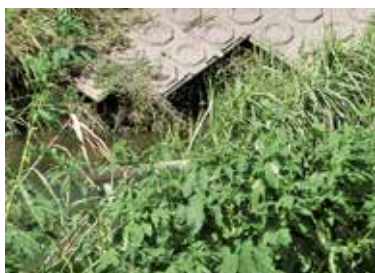
渋田川護岸崩落の様子
