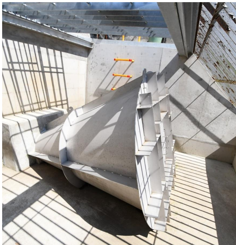
調整池からの雨水排出量を動力不要で調整できる流量制御装置 (日向岡調整池)
