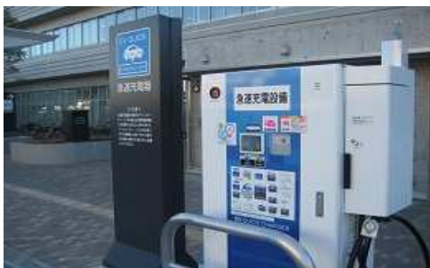
市庁舎本館に設置された 電気自動車用急速充電器
