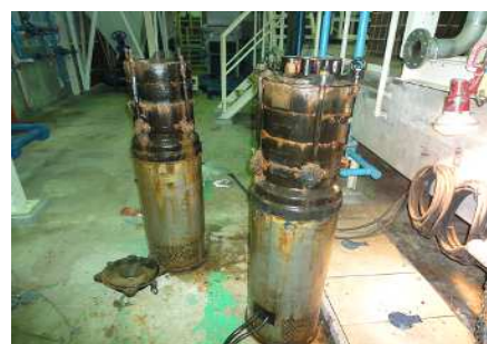
集砂ポンプの腐食
