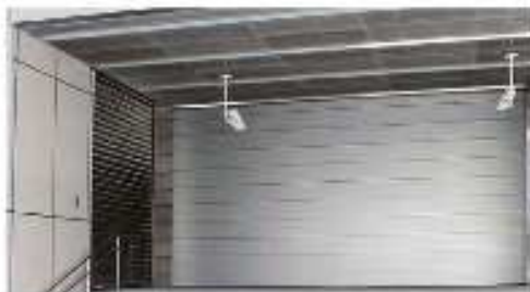
防水シャッター
