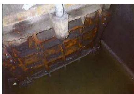
汚水流入ゲートの腐食状況
