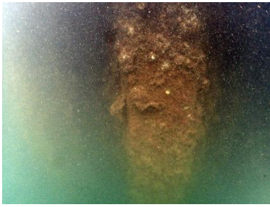
Fig.6 調査箇所①状況
