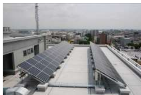
市庁舎本館には太陽光パネルが設置されています。
