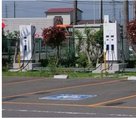
電気バス用充電設備
