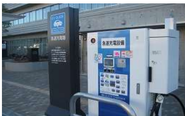
市役所本館に設置された 電気自動車用急速充電器
