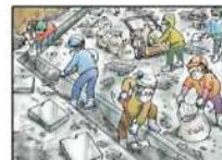
下水管や側溝の詰まりに留意
