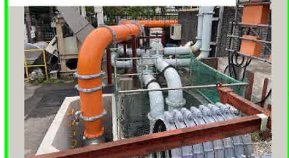
ポンプ増強（長持）⇒令和5年度完成
