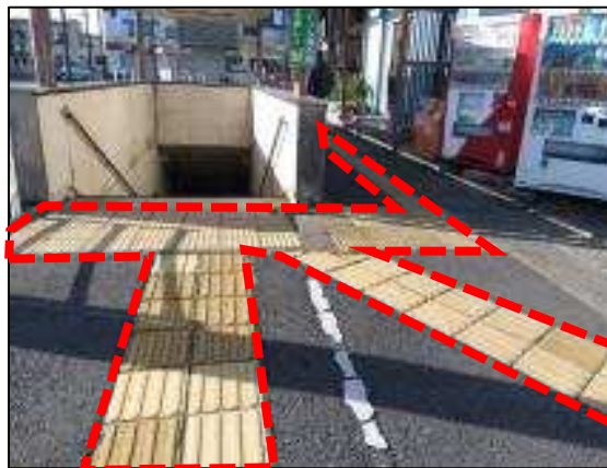
視覚障害者用誘導ブロック改修が必要な箇所 (生活関連経路 14 浅間町南原線)
